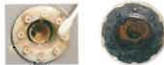
配管口も湯アカがベタッリ
